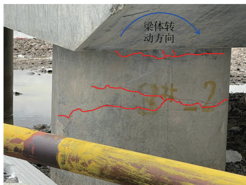
图4 桩基混凝土开裂
