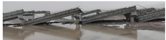
图1 野马滩2号大桥倒塌
