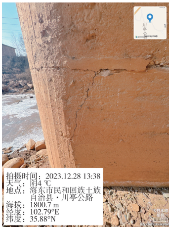
图 21 桥墩东侧剪切斜裂缝
