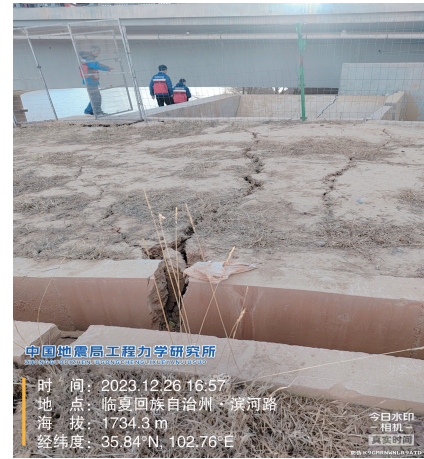
图4 北侧桥台附近地裂缝(闫培雷摄)
