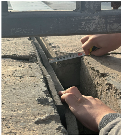
图3 南侧伸缩缝被拉开3 cm 尚未恢复
