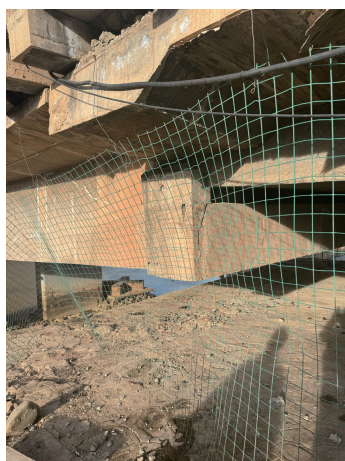
图 17 旧桥南侧挡块斜裂缝
