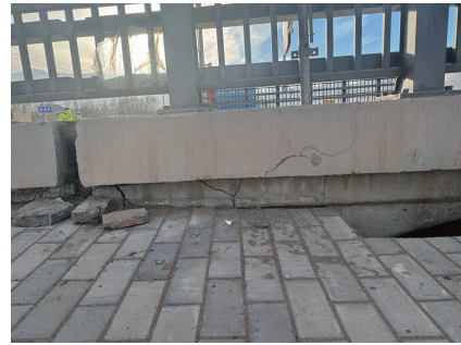
图2 南侧伸缩缝处护栏下部混凝土开裂
