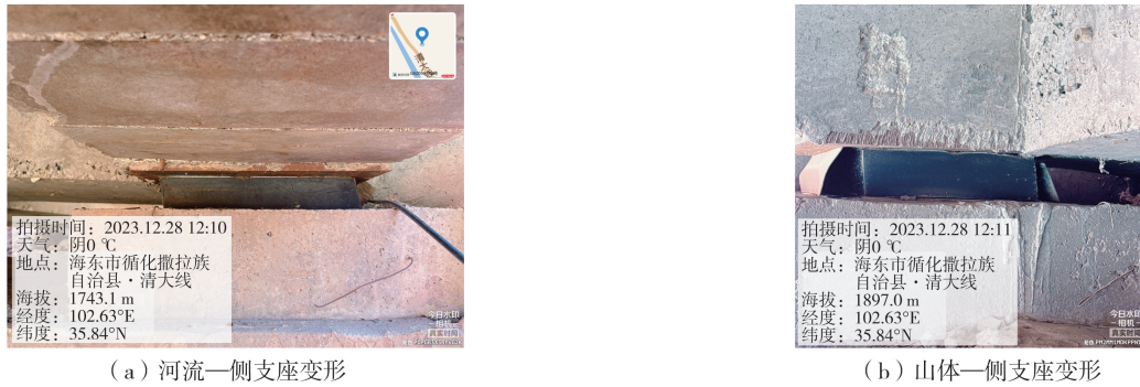
图29 310国道清大线一公路桥梁支座地震后橡胶变形
