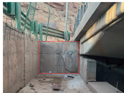
图6 北侧桥台端墙斜裂缝
