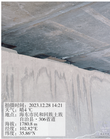
图 26 桥梁中部支座滑移 10 cm 左右
