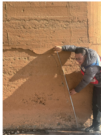
图 22 桥墩西侧 140 cm 长剪切裂缝
