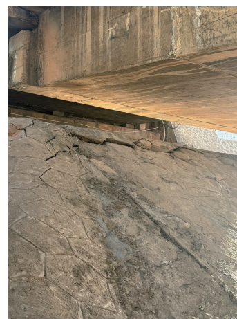
图 19 南侧场地东西向裂缝(桥横向)
