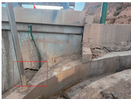
图5 北侧桥台侧墙发生严重水平裂缝
