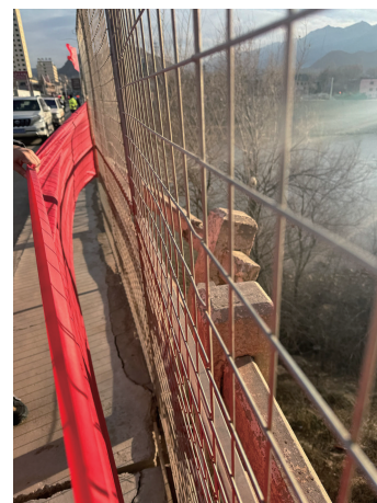
图 16 旧桥北侧护栏外闪
