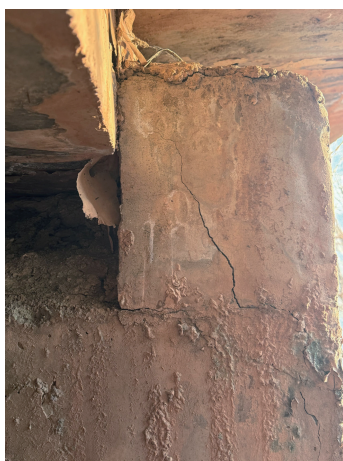
图 18 旧桥北侧挡块斜向下裂缝
