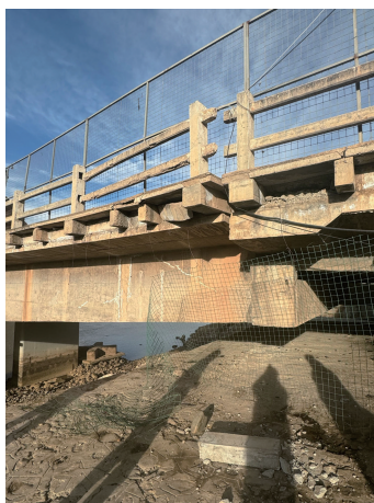
图 15 旧桥南侧护栏底部开裂外闪
