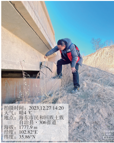
图 24 公路桥梁端部挡块严重破坏 (设置了缓冲橡胶垫)
