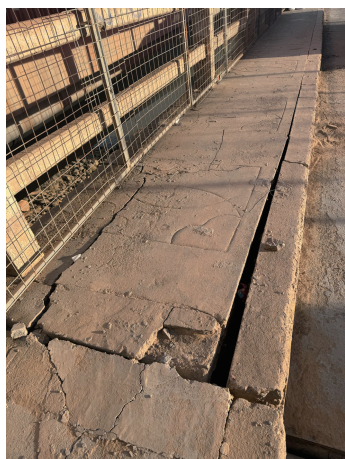
图 14 旧桥北侧梁体碰撞
