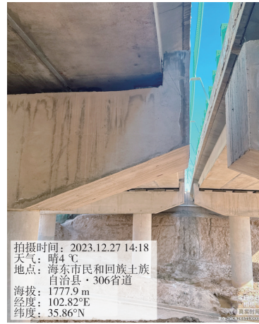
图 25 公路桥梁中部挡块开裂破坏 (未设置缓冲橡胶垫)
