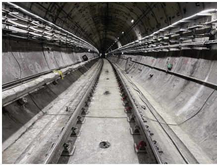
图 8 工后隧道表面情况
