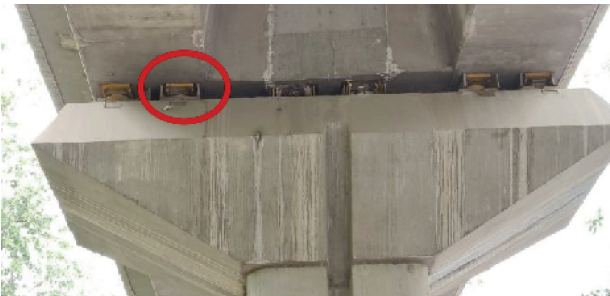
图 8 某城市轨道交通桥梁病害支座
