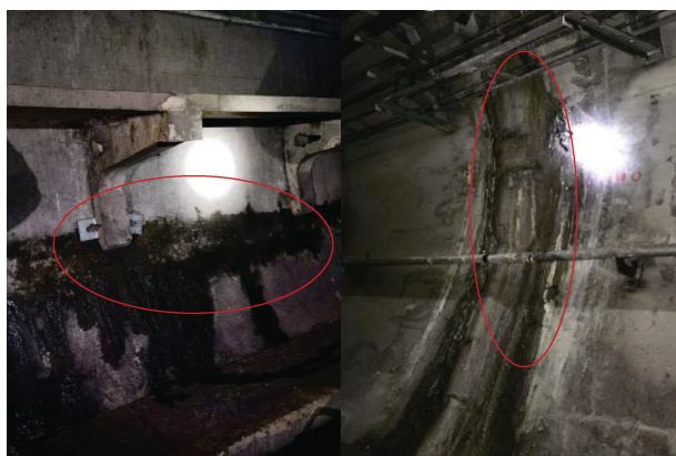
图5 施工缝、变形缝渗漏
