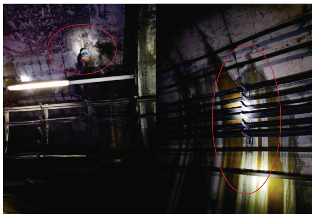
图4 穿墙管孔洞、结构裂缝渗漏
