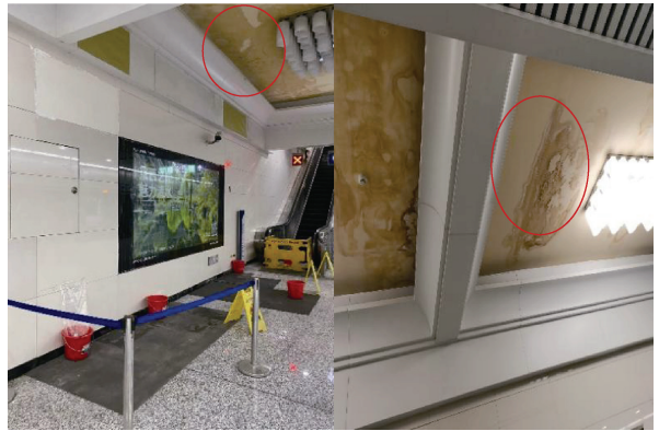
图 1 车站顶板渗漏
