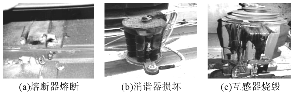
图1 设备损坏照片
