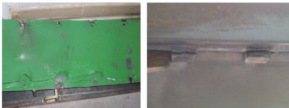
图5 长征二号丙发射台烧蚀损坏的护板
