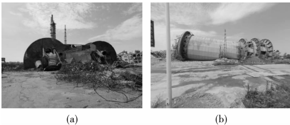
图15 造粒塔最终倒塌形态
