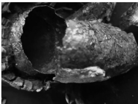
图 6 天然气管道锈蚀断裂
