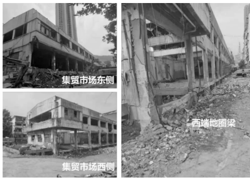
图 11 集贸市场东、西侧爆炸破坏情况
