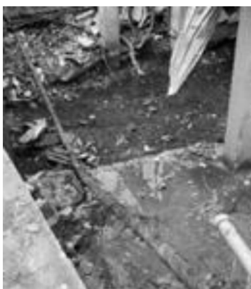
图 5 垮落的天然气管道
