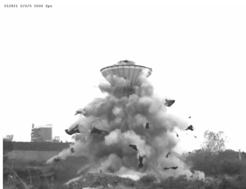
图 4 水箱水压爆破瞬间(第 12820 帧)
