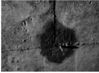
点状渗漏修复前
