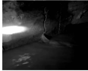
结构裂缝渗漏修复前
