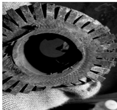
图1 泄漏点管道内壁“V”形沟减薄
