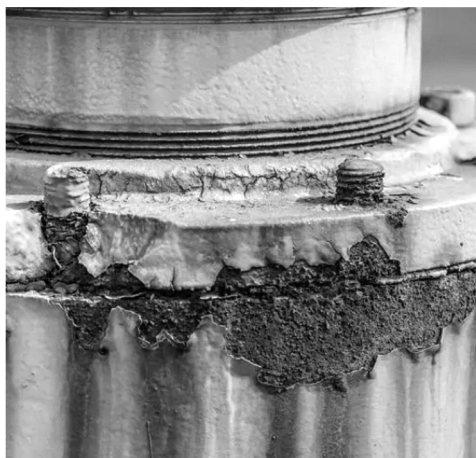
图1 钢材腐蚀实物图
